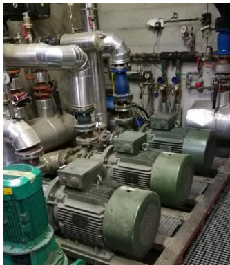
Gruppi pompaggio linea 2
