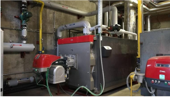
Generatori di calore a metano
