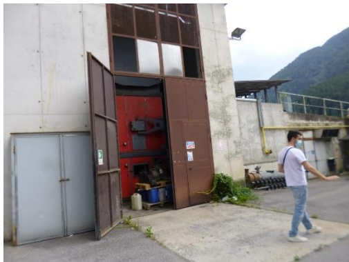
Caldaia a biomassa M2
