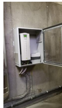
Inverter pompe di rete
