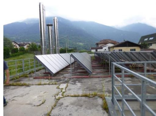
Impianto solare termico
